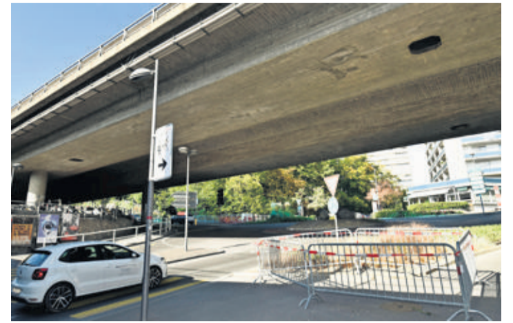
Des barrières ont été disposées sous l'ouvrage pour mettre les piétons à l'abri des chutes de fragments. PATRICK MARTIN
